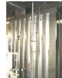
機械室にある還水槽 写真は容量5t、2*1*2.5h ステンレス板で囲まれている 右側上部は補給水管
