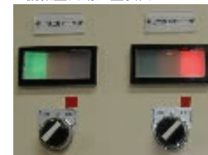
機械室内動力盤表面
