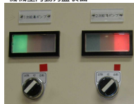
機械室内動力盤表面
