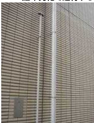
配管と支持金具に腐食がないか？
