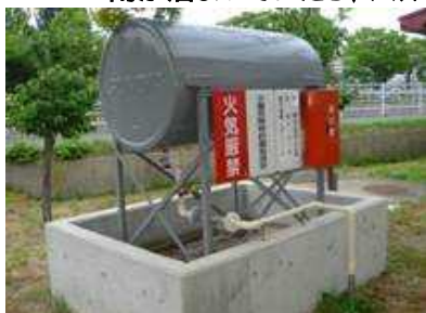
オイルタンク・防油堤全景
