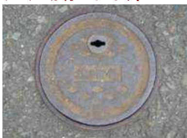
止水弁弁蓋(穴から土砂・水が入り、中に堆積しやすい)
