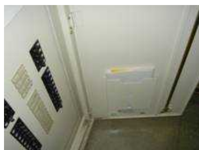
盤の扉には、回路図もホルダーに収まっています。(回路を追加等したら、施工業者に回路図も直させましょう)
