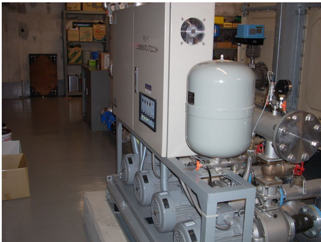
加圧給水 ポンプ
