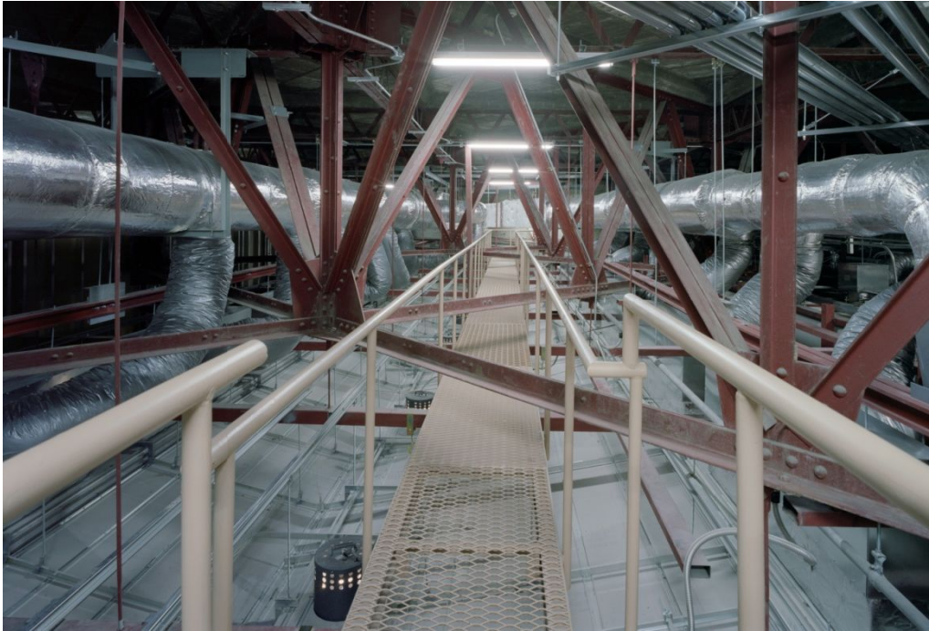
ホール客席上部 ダクト点検歩廊
