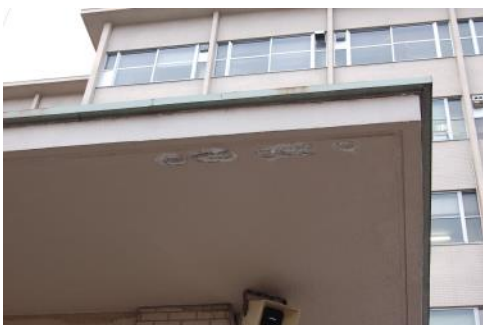
軒裏のはく離
