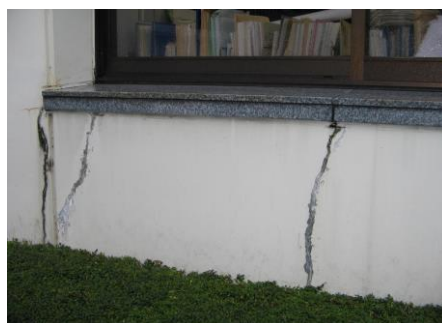
外壁仕上げのひび割れ
