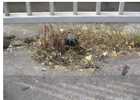
ルーフドレンの詰り(雑草が繁茂状態) ここまでくると最悪です。
