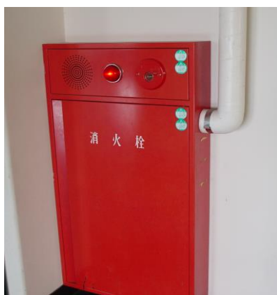
屋内消火栓箱（露出型）
