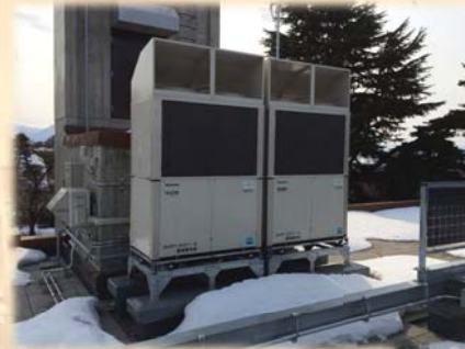
GHP (ガスヒートポンプエアコン) 会議室暖冷房用
