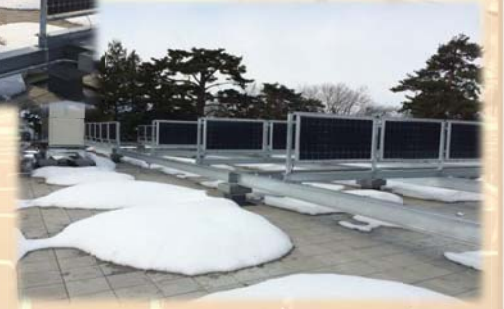
太陽電池パネル 垂直設置 10Kw
