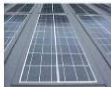
80kWの太陽光発電
