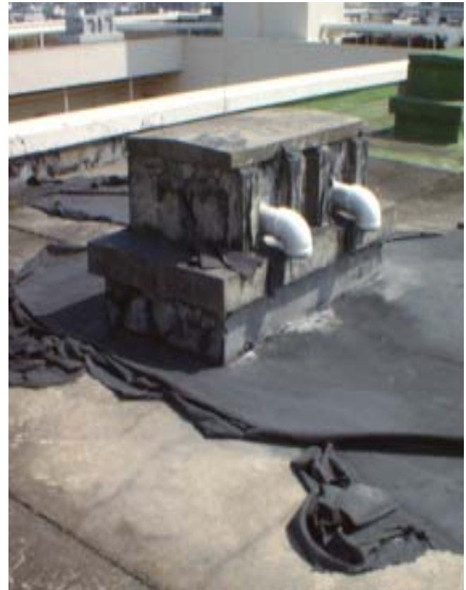
事例2 防水層の破れ (施工不良、維持保全不良)
