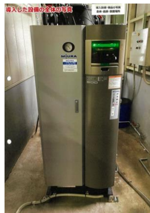
導入した高効率ボイラ
