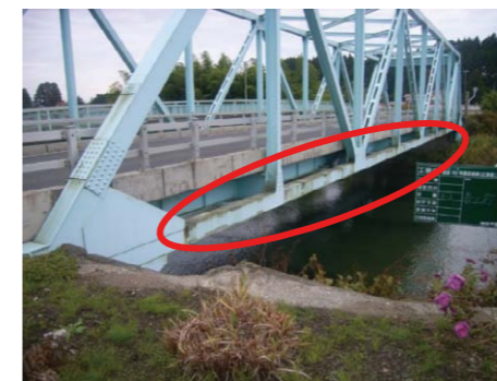
(下部工の断面欠損、防食機能の劣化)
