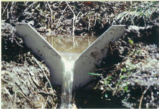
【漏水状況(着工前)】
