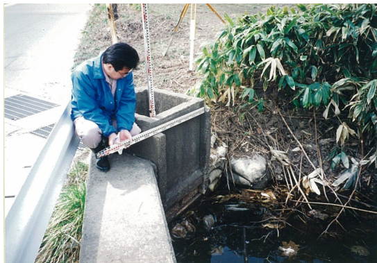
【老朽化した取水施設の状況(着工前)】
