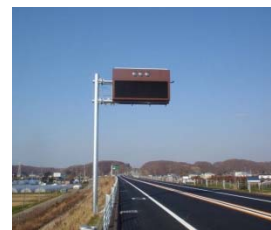
② 道路情報板設置状況及び情報表示例
