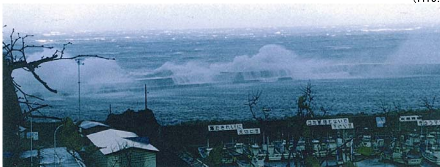
外郭施設の整備不足により、越波等が生じ、港内静穏度が非常に悪く、漁船の係留等に支障がある。
