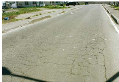
老朽化により道路の舗装面に凹凸があり、漁獲物などの運搬に支障をきたしている。
