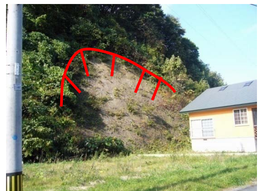
No.20付近の小崩落状況
