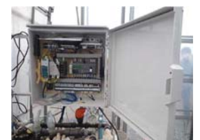
施設園芸の自動かん水・施肥装置
