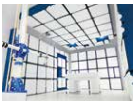
電磁妨害波測定や電磁感受性試験を行う小型電波暗室
