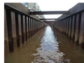
鋼矢板の腐食が進行している排水路
