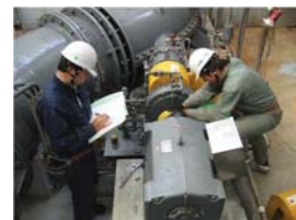
老朽化したポンプの機能診断
