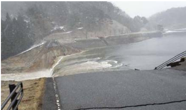
写真1 東北地方太平洋沖地震による決壊 (福島県)
