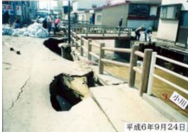
浸水被害状況(平成6年9月23日～24日)
