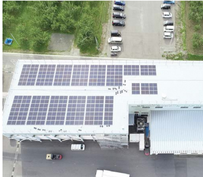
倉庫屋根太陽光発電
