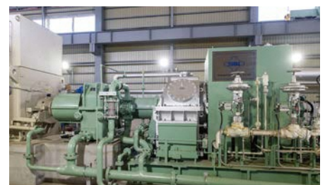
チップを燃焼した熱により発生した蒸気の圧力でタービンを回し発電する
