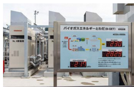
発電設備「コージェネレーションシステム」
