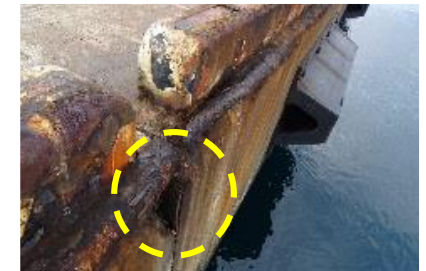
岸壁上部工のコンクリート剥落(青森港沖館埠頭)
