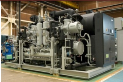
高効率冷却装置
