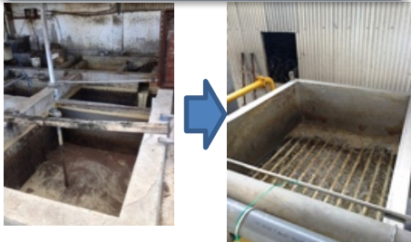
既存の排水処理槽
