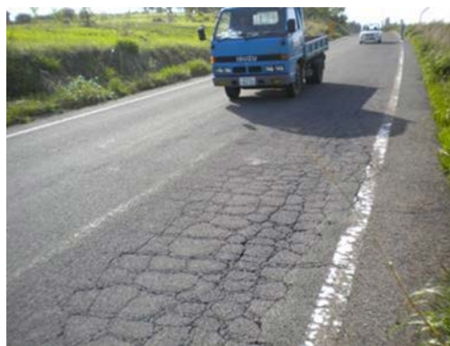
路面のわだち、ひび割れの状況
