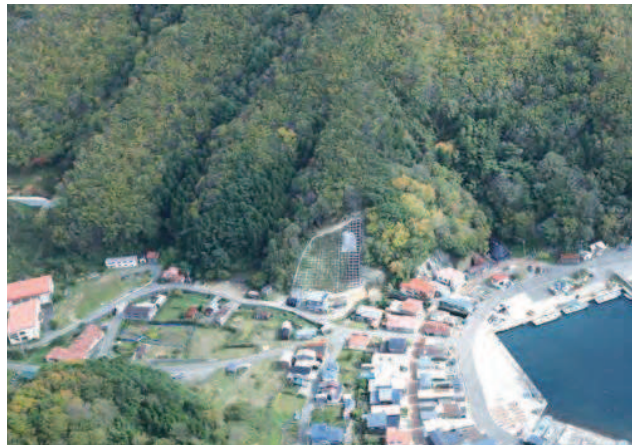
九艘泊区域急傾斜地崩壊対策事業(むつ市脇野沢九艘泊)現場打吹付法砕工
