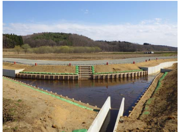
農用排：切佐坂（環境配慮型水路）
