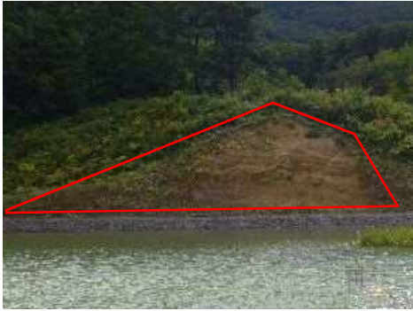
今回施工箇所。切土面が裸地のままで、降雨等により浸食される恐れも・・・
