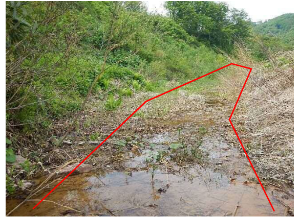
排水工施工箇所。湿地状態となっている。
