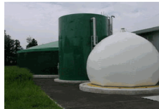
バイオガスプラント
