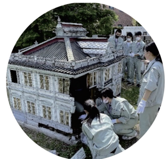
第14回 地域づくり活動部門 最優秀賞 「青森県立弘前工業高等学校建築科第3学年模型制作班 (ミニチュア建造物修理)」
