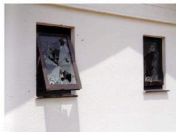
割れたまま放置されている窓ガラス
