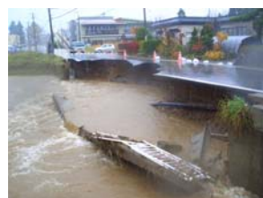
災害発生時の状況
