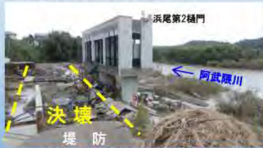
98.6k 左岸堤防決壊箇所(須賀川市)
