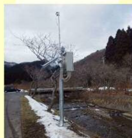
簡易型河川監視用カメラ
