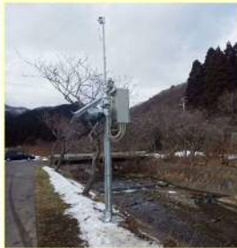
簡易型河川監視用カメラ設置例
