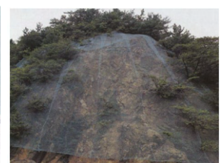
▼落石防護ネット
