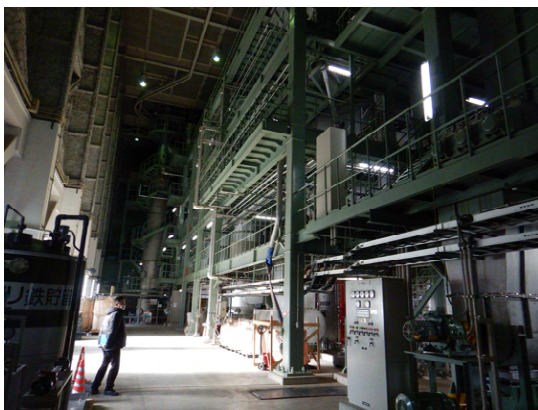
●汚泥焼却設備(青森県岩木川浄化センター)
