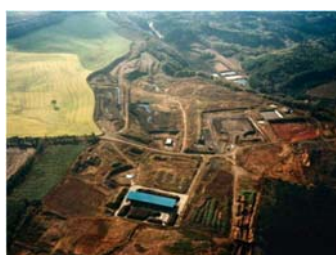
ごみを片づける前の現場 (平成12年10月)
