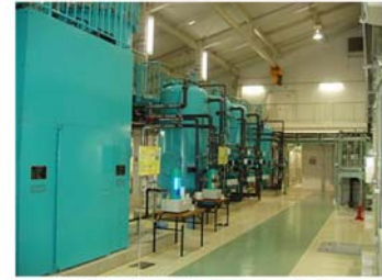
しんしゅつすいしよりにしせつ ないぶ 浸出水処理施設の内部
