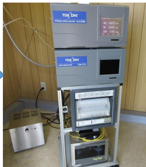
常時監視測定局内の大気汚染自動測定機
