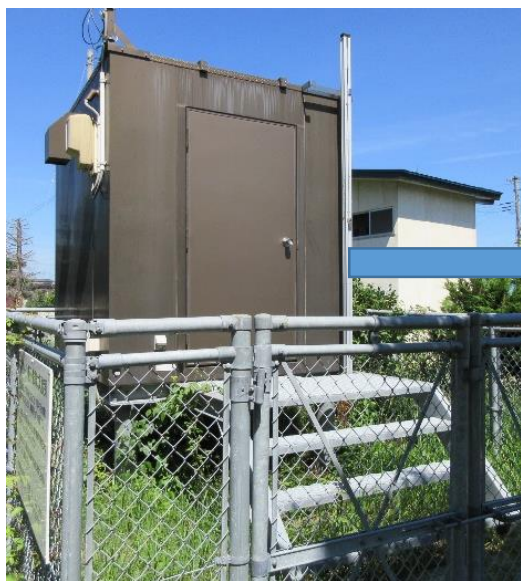
常時監視測定局の外観
