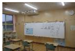
県立学校への冷房設備設置状況
