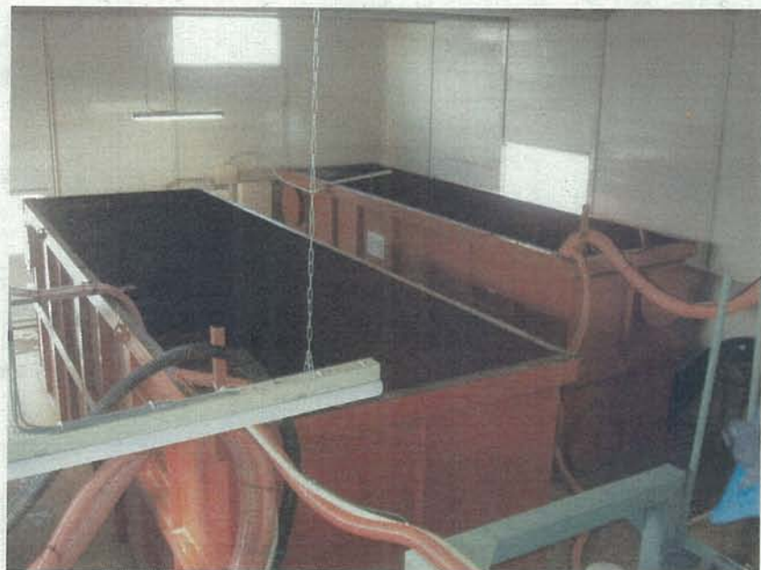
汚泥濃縮貯留槽
