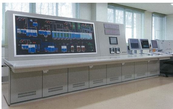
施設の機械の操作と水のきれいさを確認する部屋
