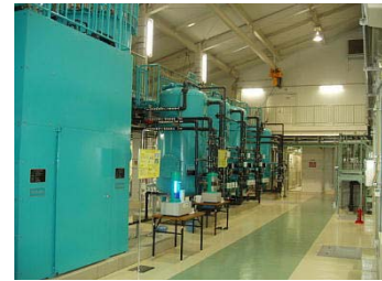
しんしゅつすいしよりにしせつ ないぶ 浸出水処理施設の内部
