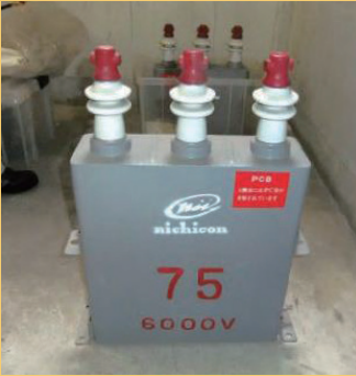
電力用コンデンサー
