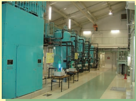
浸出水処理施設内部
