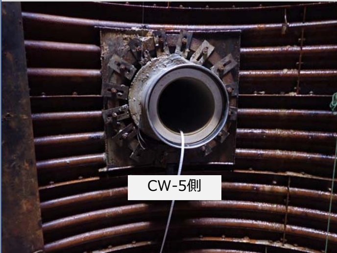
CW-3～CW-5 地下水流下設備
