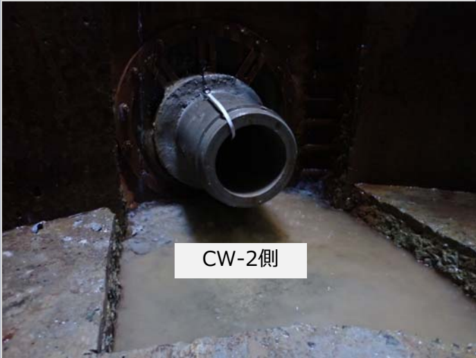
CW-2～CW-3 地下水流下設備
