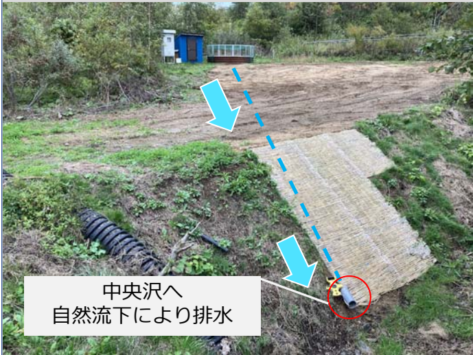
CW-1～中央沢 地下水流下設備
