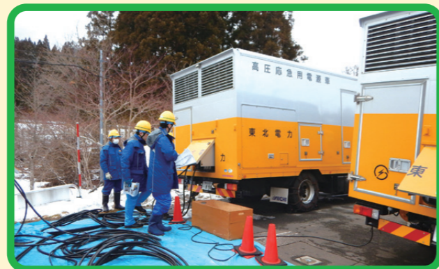
★停電したときに電気を送ることができる車を動かす訓練をしている様子
