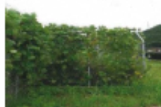
草木の成長によるフェンスの倒壊事例-1
