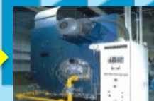
既設ボイラー
