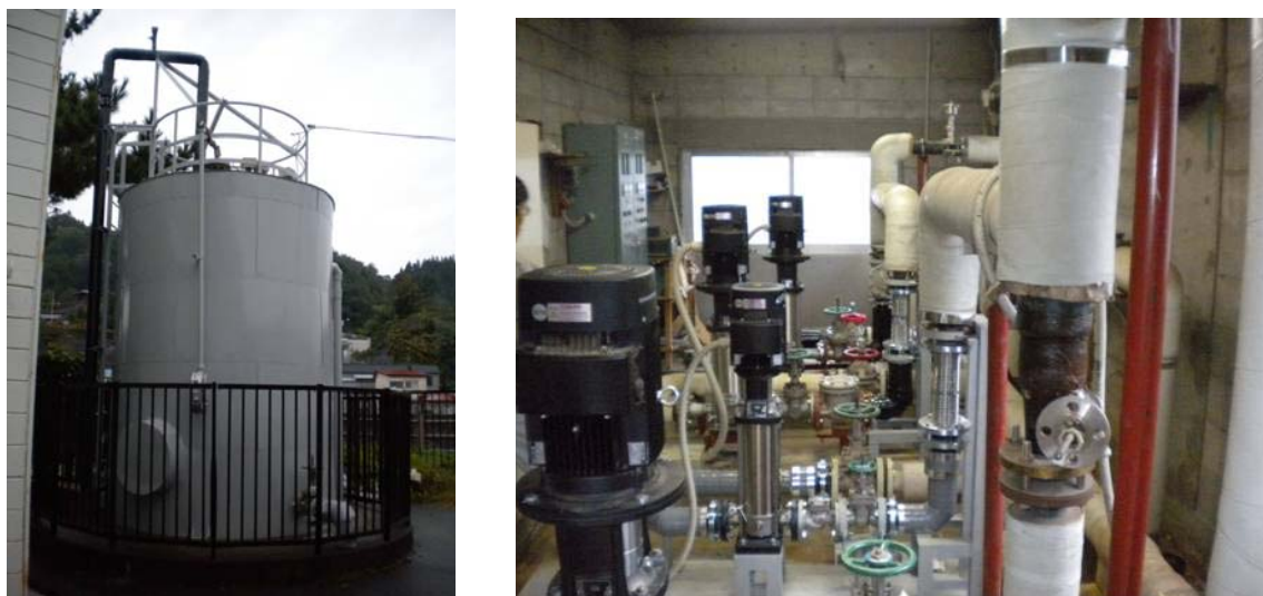
図 2.3-10 駅前配湯所 (左：貯湯タンク、右：ポンプ室)
