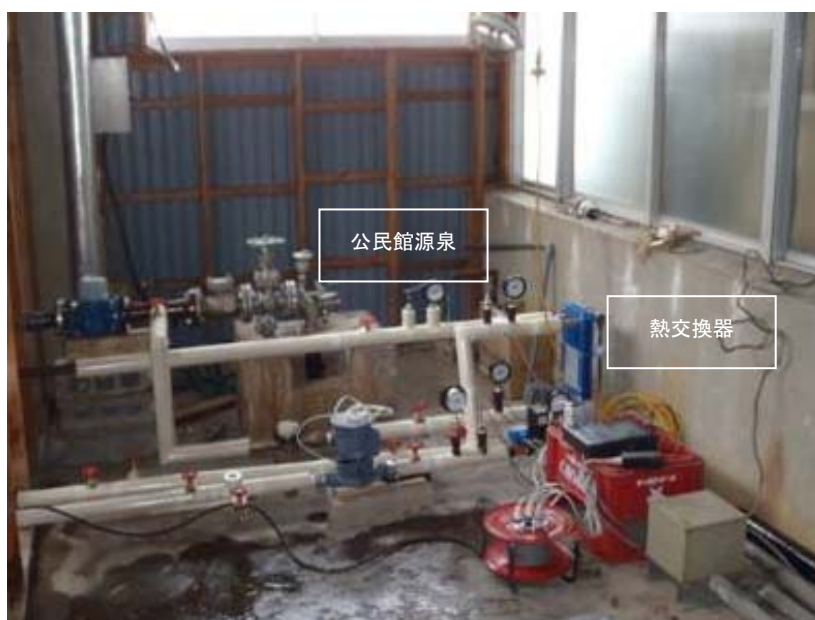
図 4.2-5 公民館源泉ならびに熱交換設備
