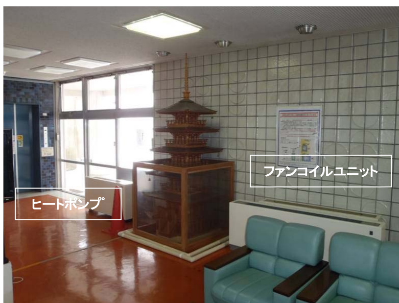
図 4.3-4 空調機（ファンコイルユニット及びヒートポンプ）
