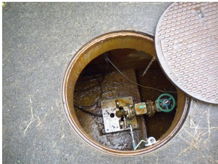
図 2.3-5 赤湯源泉 坑口ピット
