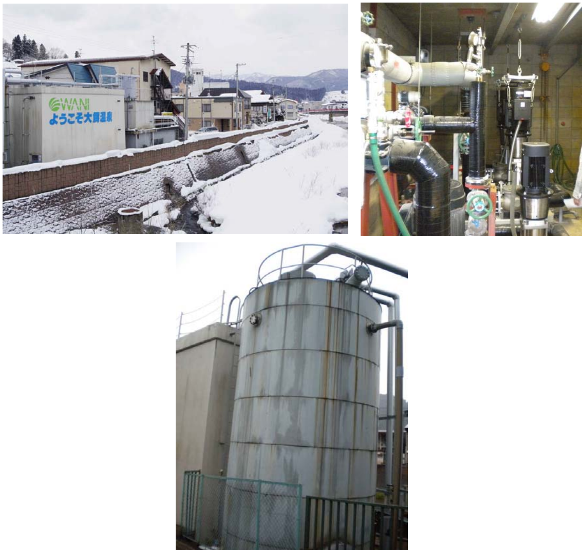
図 2.3-9 青柳配湯所 (左上: 全景、右上: ポンプ室、下: 貯湯タンク(100t))
