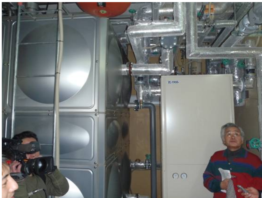
図 6.2-4 登府屋旅館機械室 (右：ヒートポンプ、左：貯水タンク)
