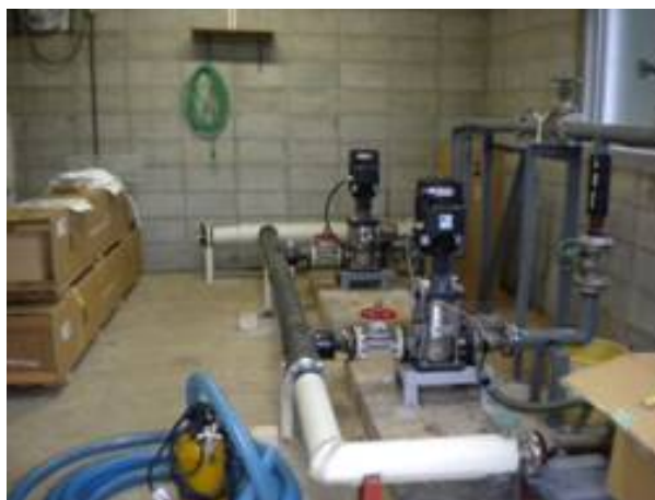
図 2.3-11 菴頭配湯所 (ポンプ室)
