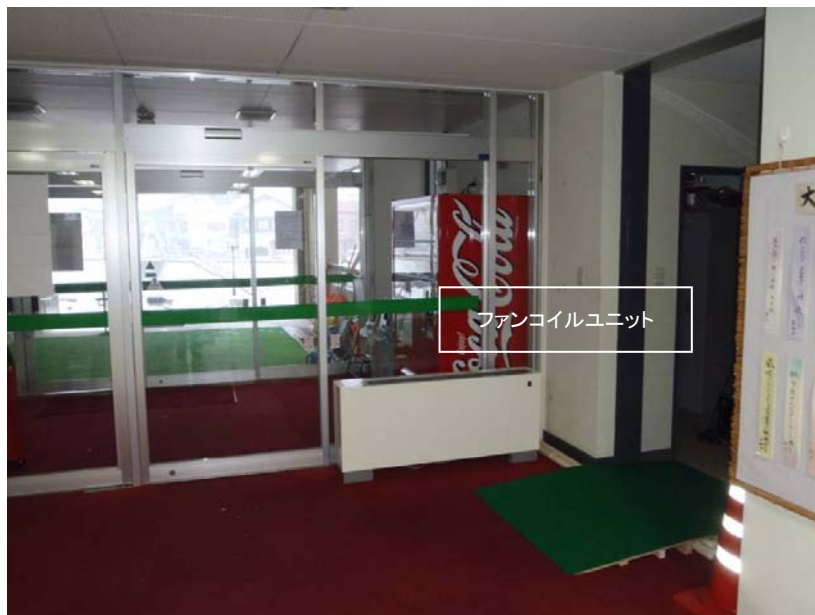
図 4.2-4 大鰐町中央公民館 1F ロビーに設置した空調機（ファンコイルユニット）
