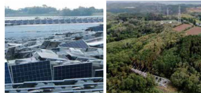
千葉県市原市水上設置型太陽光発電所損壊
