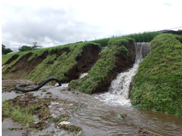
【水田の法面崩壊（田子町）】
