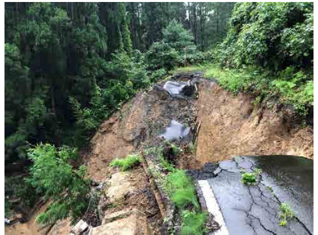
【林道被害（中泊町）】
