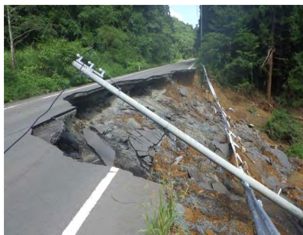
【農道崩落（弘前市）】
