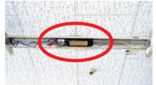
蛍光灯安定器の設置例
